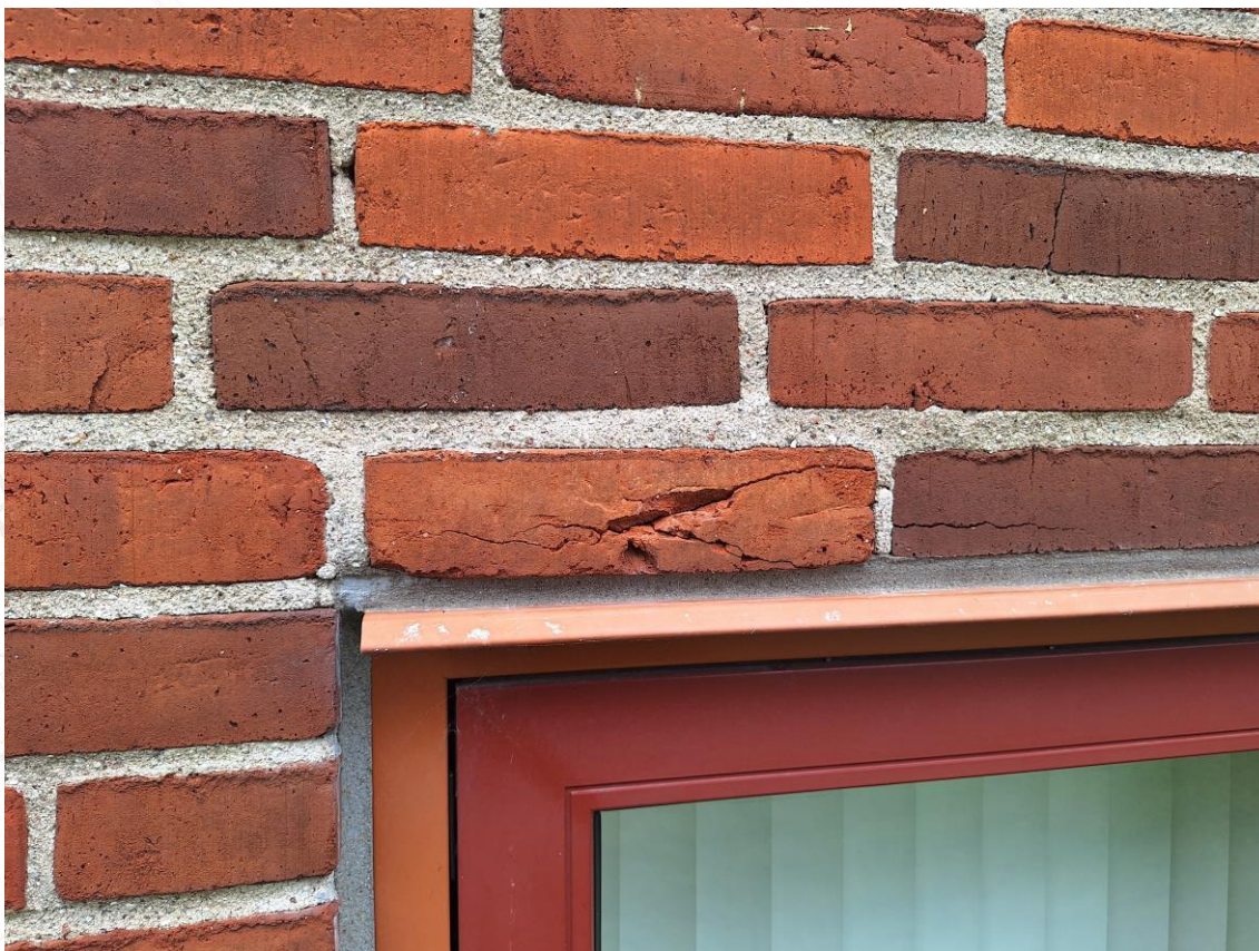
Ødelagte sten bør udskiftes.
