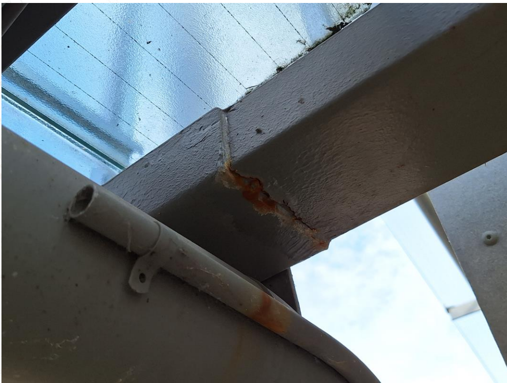
Her ses at de malerbehandlede tagrender, som skal optage regnvandet fra glasoverdækninger, ses med begyndende rust og tæring i samlinger.
