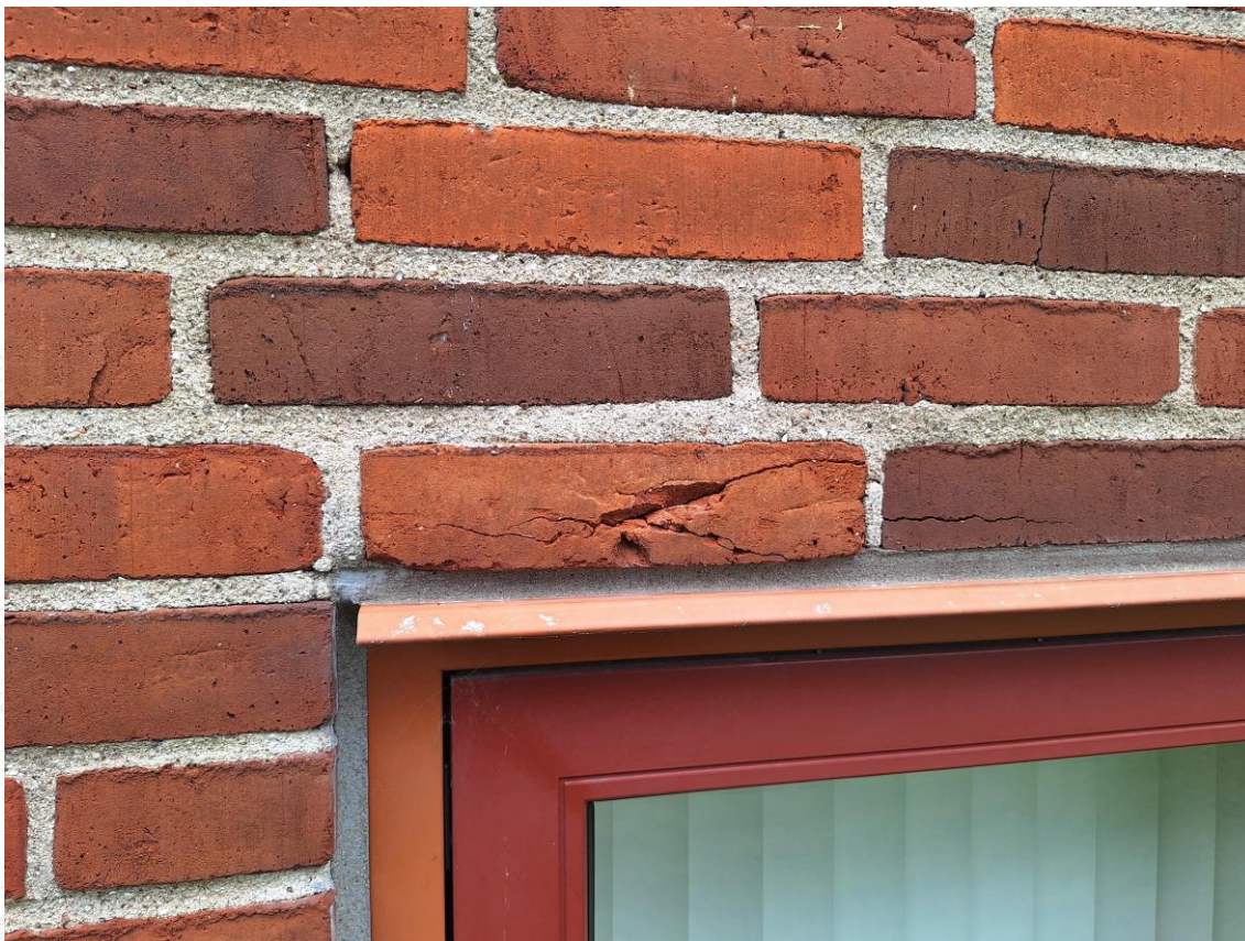
Ødelagte sten bør udskiftes.
